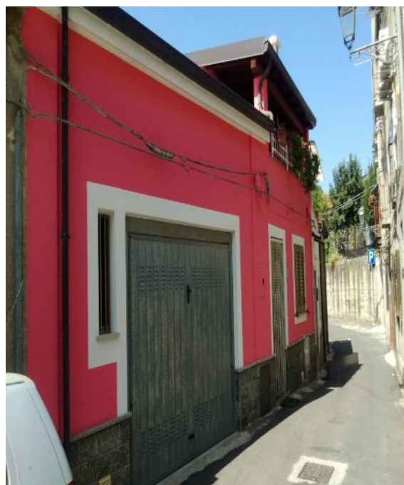
Figura 28 con la presente fotografia si evidenzia che nel ripristino delle facciate il colore utilizzato non è compatibile con i colori tradizionali dell'ambito storico di appartenenza
